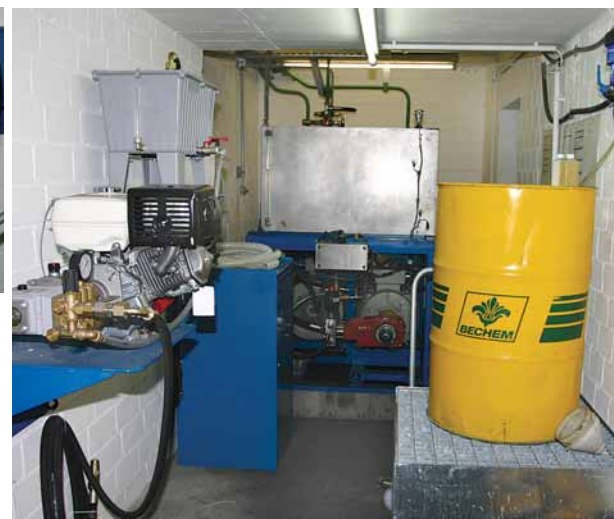
Pumpenstation: Speck-Triplex-Pumpe mit Motor, Pumpenrahmen, Wassertank und Klemmkasten für die Motoren.
